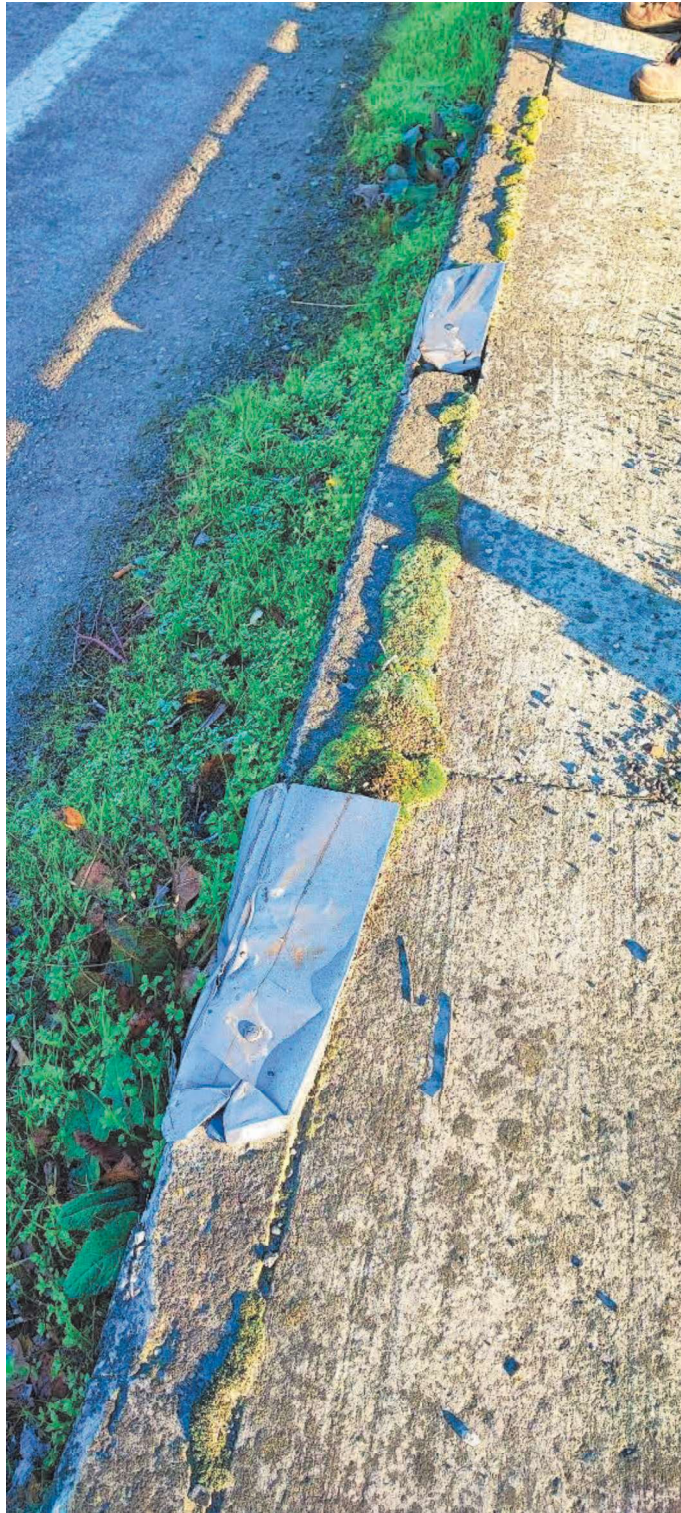
Foto 4 – Lastre coprigiunto danneggiate o deformate sulla banchina lato a monte. Si prevede la sostituzione e la pulizia delle canalizzazioni.
