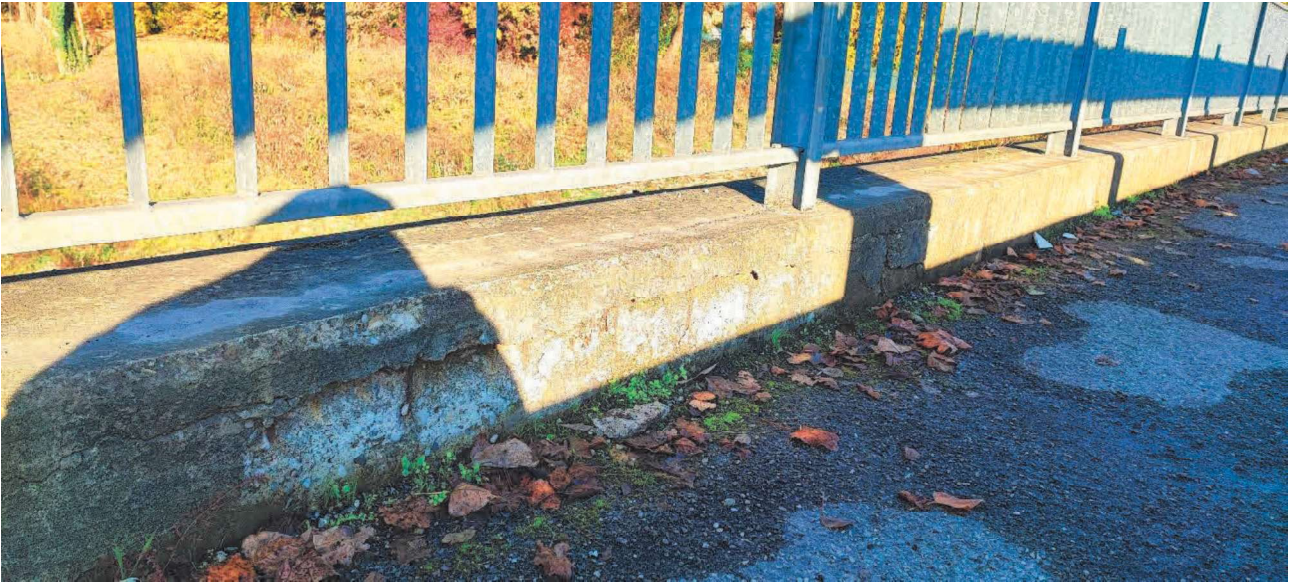
Foto 14 – Ripristino locale del danneggiamento del parapetto della pista ciclabile.
