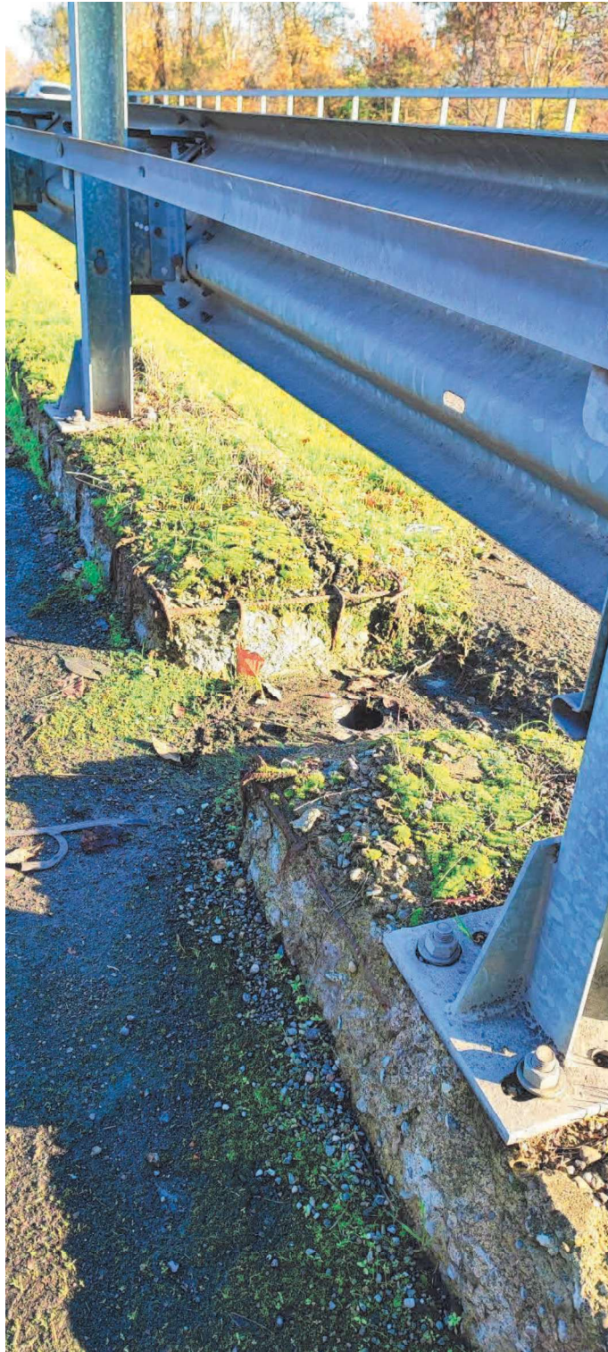
Foto 12 – Pulizia e sgorgo dei canali di scolo principale e riposizionamento dei chiusini di protezione dove mancanti.
