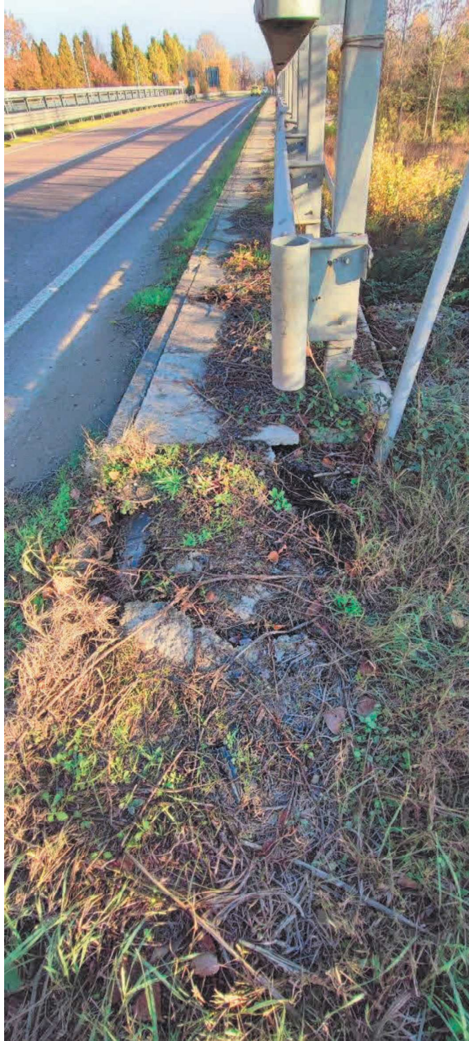
Foto 1 – Rifacimento zona terminale lato Rubiera. Si prevede la demolizione e la rimozione dell'elemento
