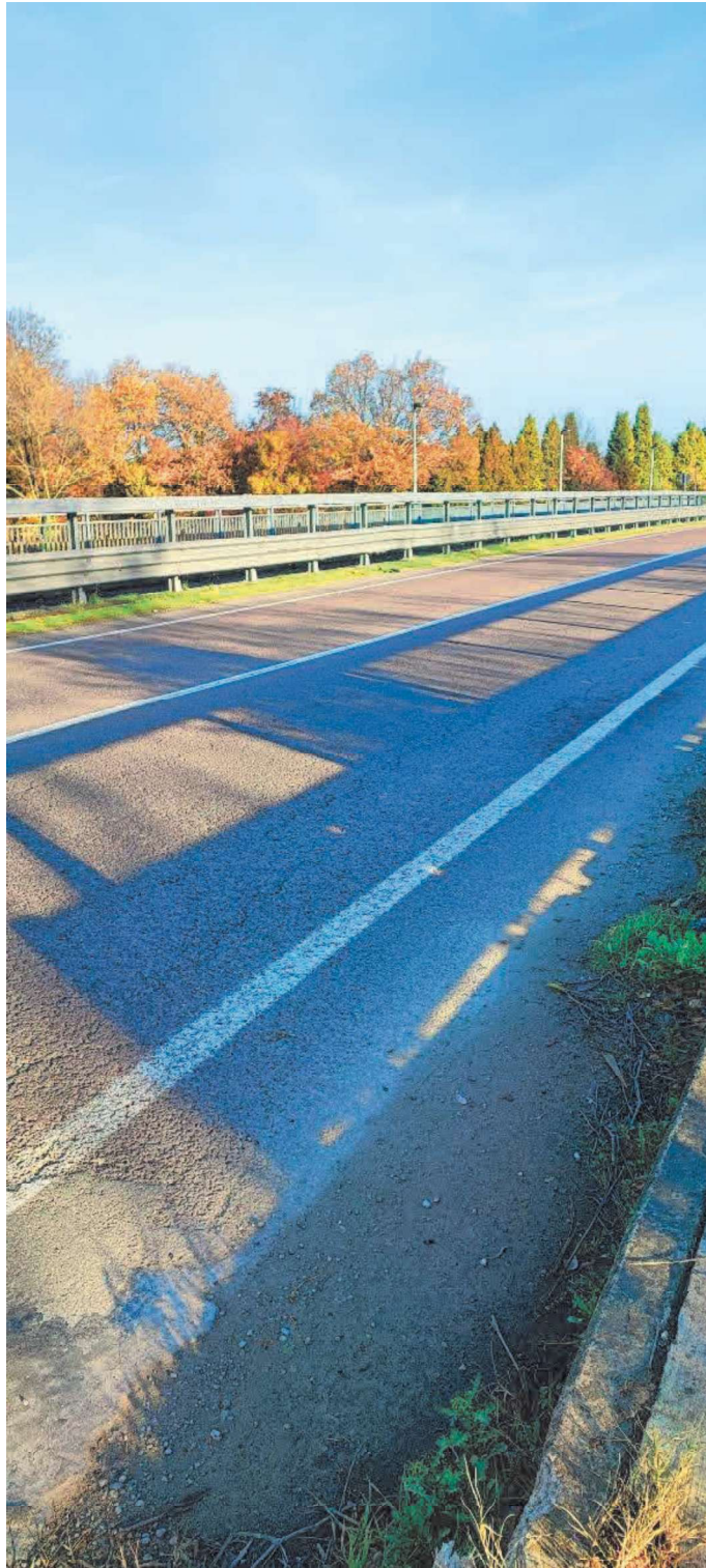
Foto 5 – Sede stradale lato Rubiera ammalorato. È previsto il rifacimento dello stesso contestualmente alle lavorazioni di creazione del giunto
