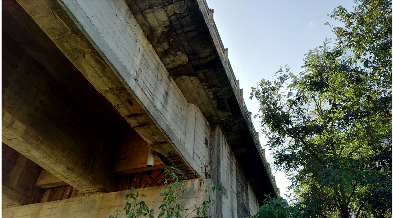
Figura 4 – dilavamento, distacco del copriferro
