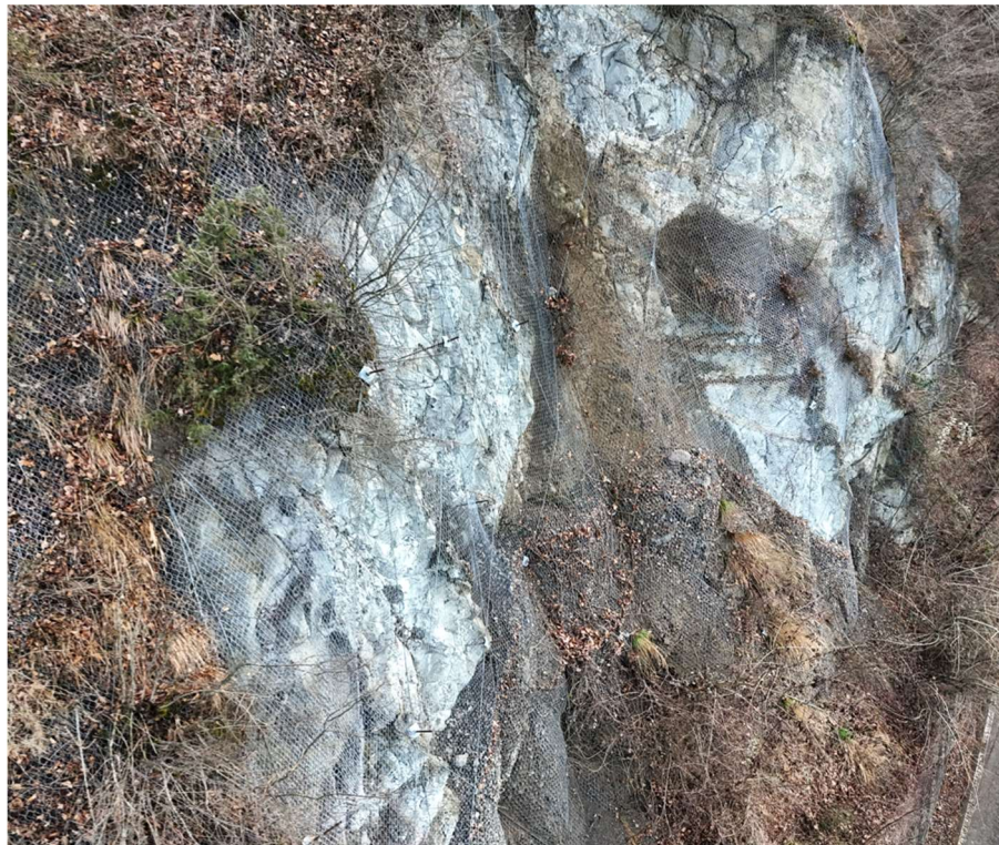
Figura 11 – Ciglio superiore del rafforzamento corticale presente allo stato di fatto.
