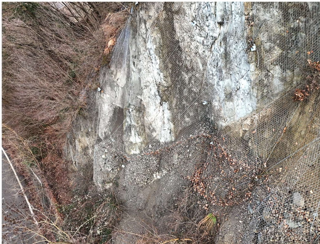
Figura 10 – Rafforzamento corticale ammalorato, chiodi denudati o completamente estratti e tasche di materiale alla base che deformano la rete ben oltre il livello di guardia.
