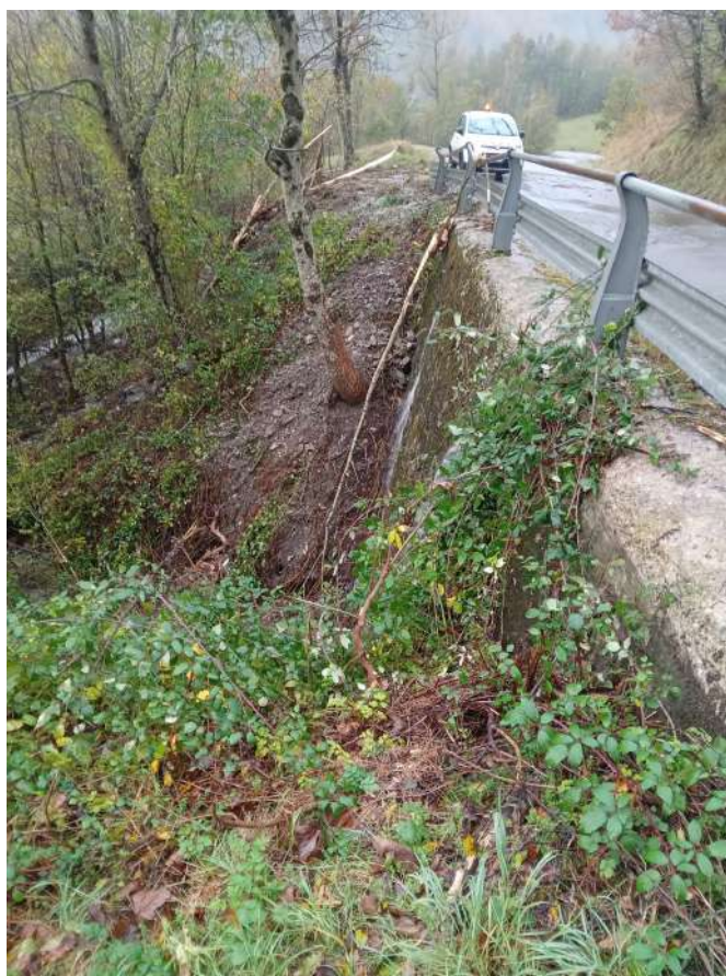
Foto 7 – Discesa dell'acqua superficiale sulla sede stradale ad effetto cascata verso valle
