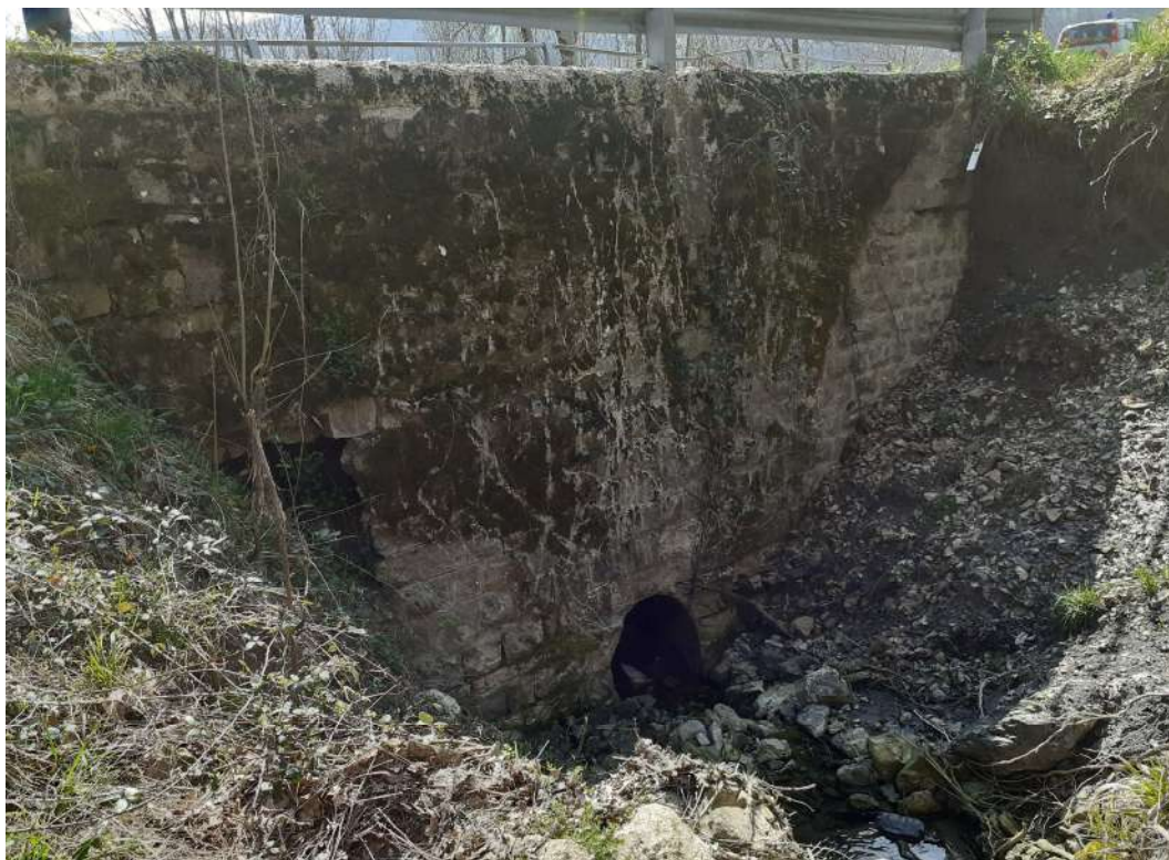
Foto 9 - vista del muro in sasso lato monte che presenta segni di ammaloramento. In basso l'attuale attraversamento idraulico cementato passante sotto piano strada
