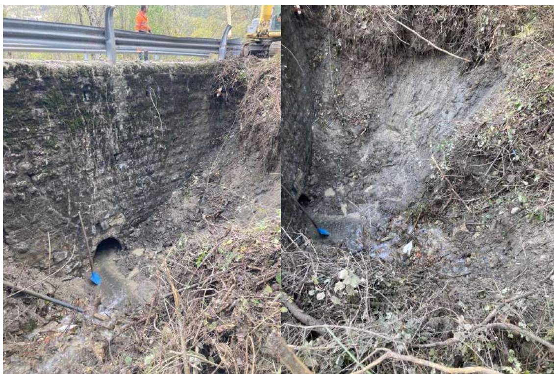
Foto 3 e 4 - Viste a monte dell'attraversamento idraulico intasato con detriti e fango
