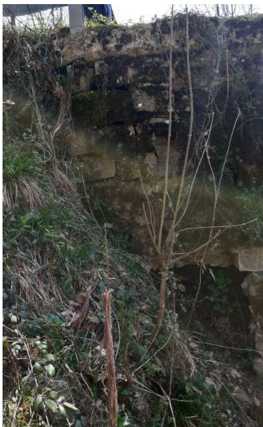
Foto 10 - Vista del dissesto della muratura in sasso del muro lato monte
