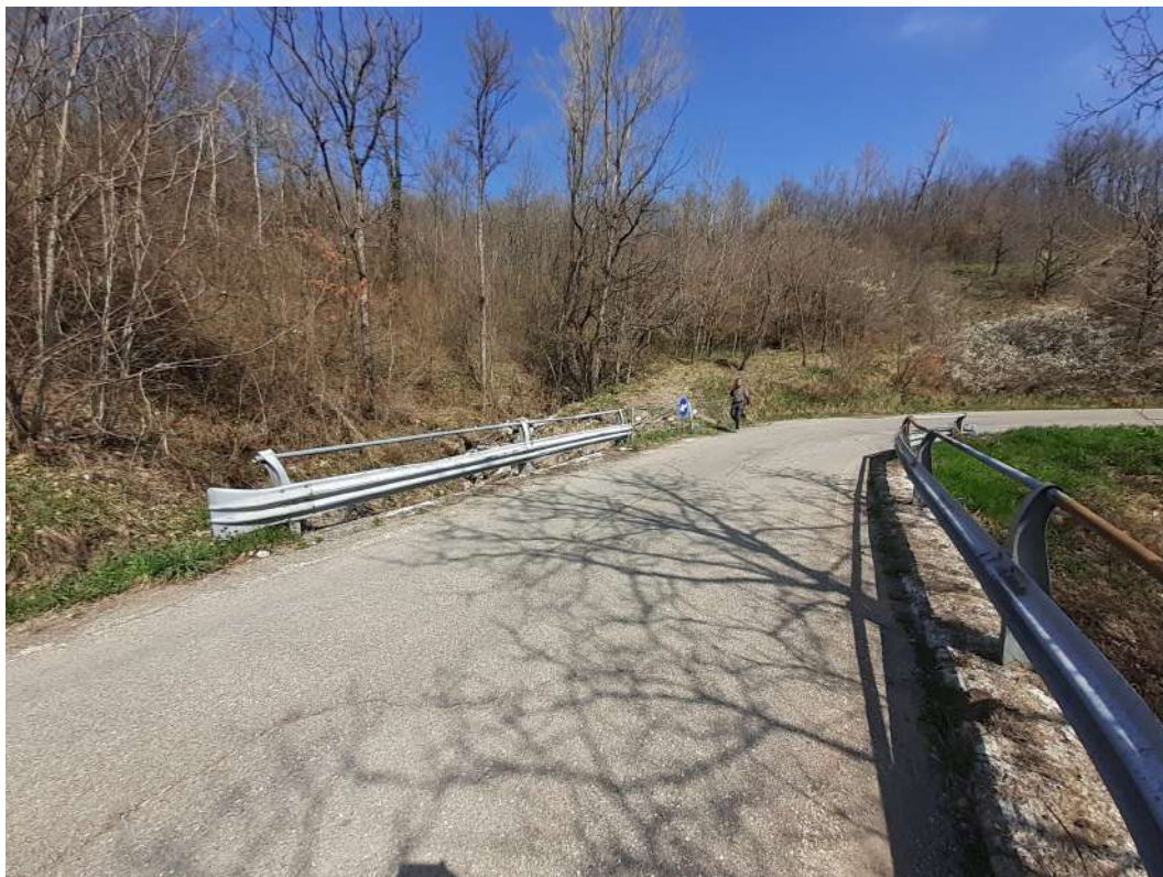
Foto 8 – vista del tratto oggetto di intervento, delle barriere stradali e dei degradi della pavimentazione stradale
