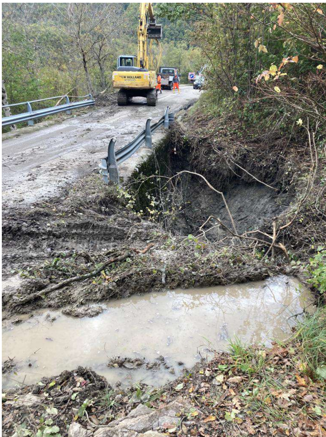
Foto 5 – Operazioni di pulizia della carreggiata stradale dopo gli eventi meteo dei primi di Novembre dell'anno 2023
