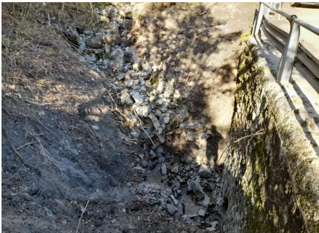
Foto 6 – Catino naturale di monte che necessita di operazioni di pulizia dai detriti
