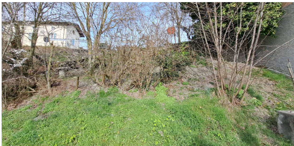
Foto 2 – Vista da valle del terreno franato della scarpata stradale, in corrispondenza del piede del dissesto.
