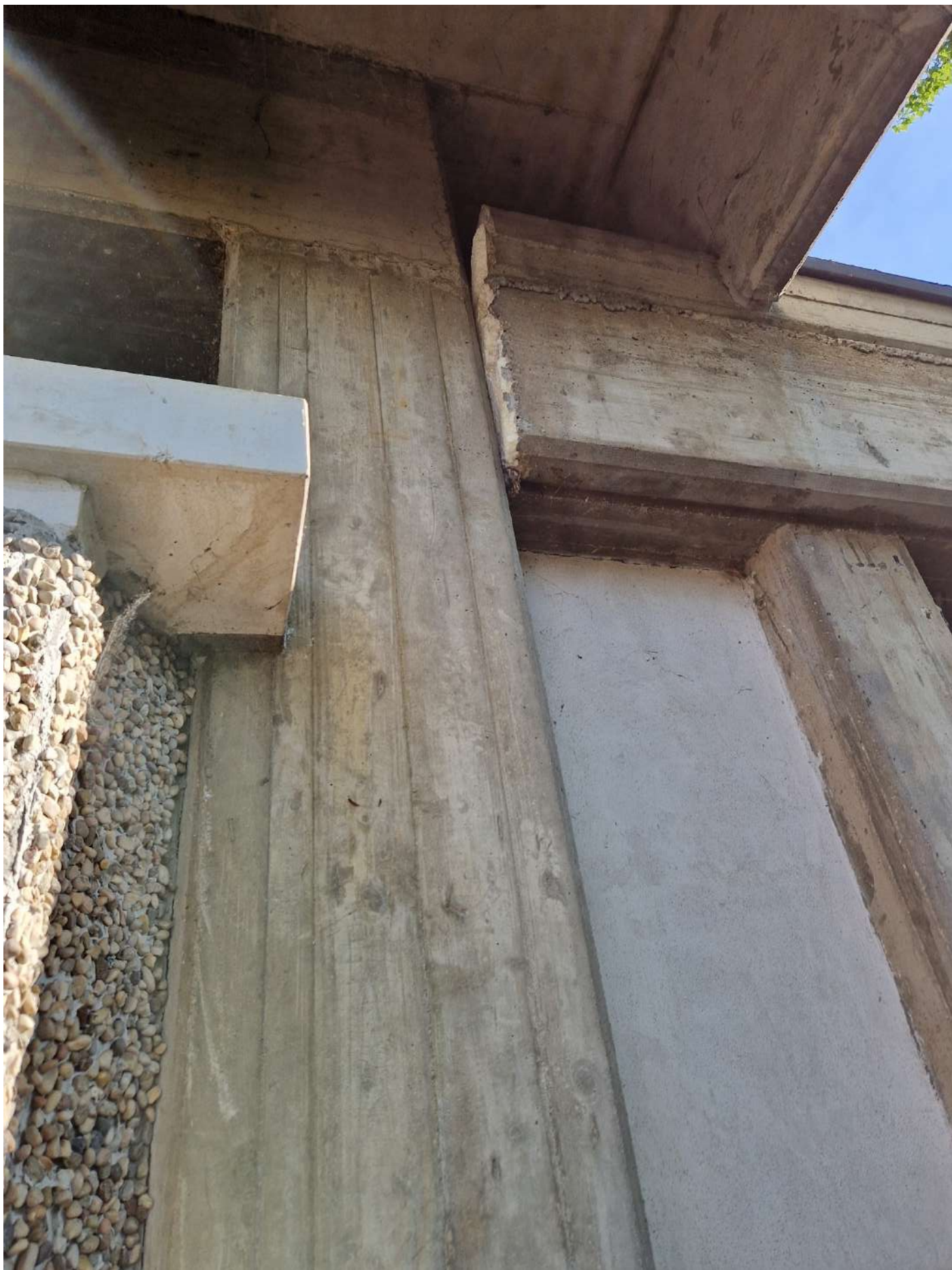
GIUNTO INADEGUATO NEL CORSELLO TRA U.S.1 e U.S.2
