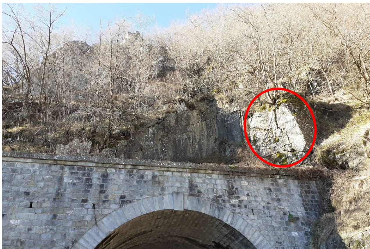
Foto 1 – Vista della parete rocciosa sopra l’imbocco nord della galleria di Civago al km 31+750 della SP 9, si vede in primo piano il blocco roccioso che presenta evidenti e profonde fessurazioni.
