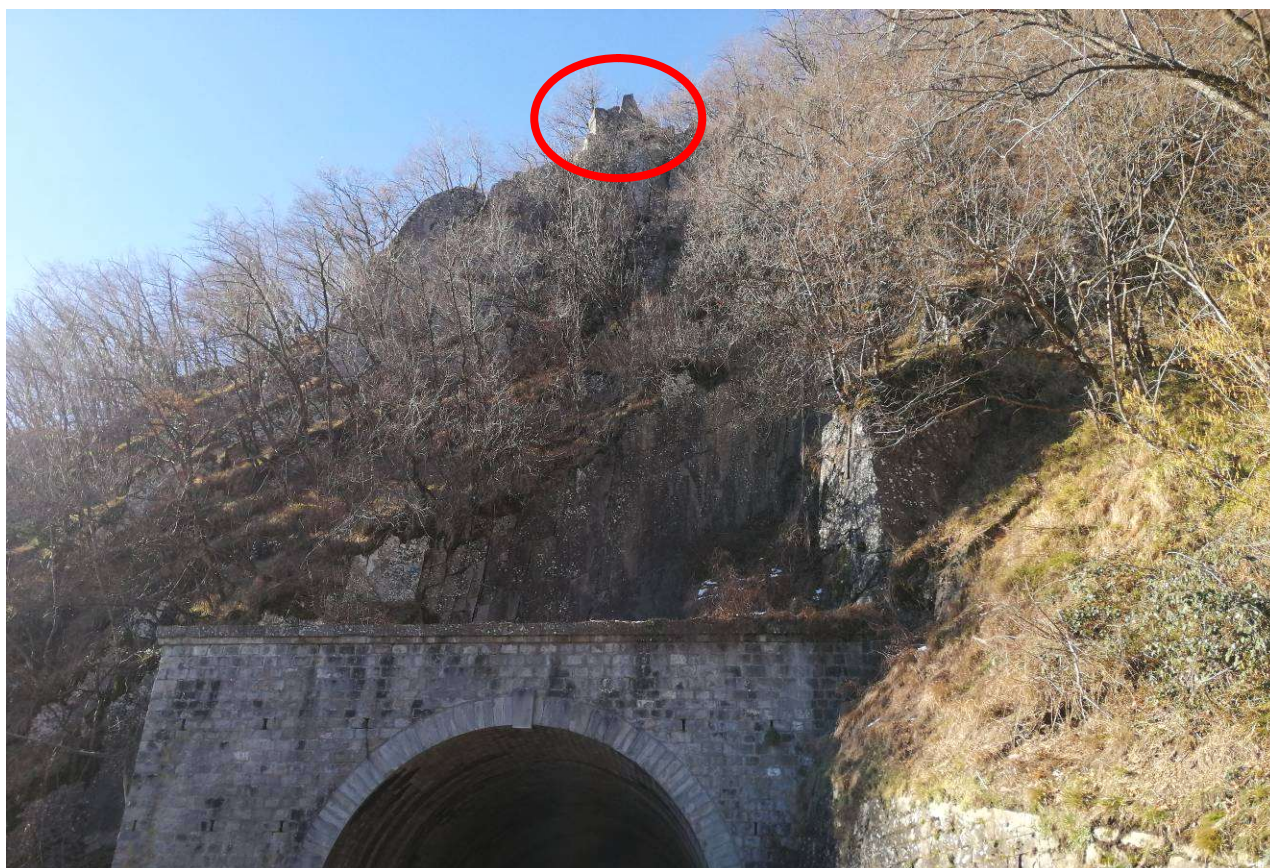
Foto 2 - Vista della parete rocciosa sopra l'imbocco nord della galleria di Civago al km 31+750 della SP 9, si evidenzia la posizione del "pinnacolo"
