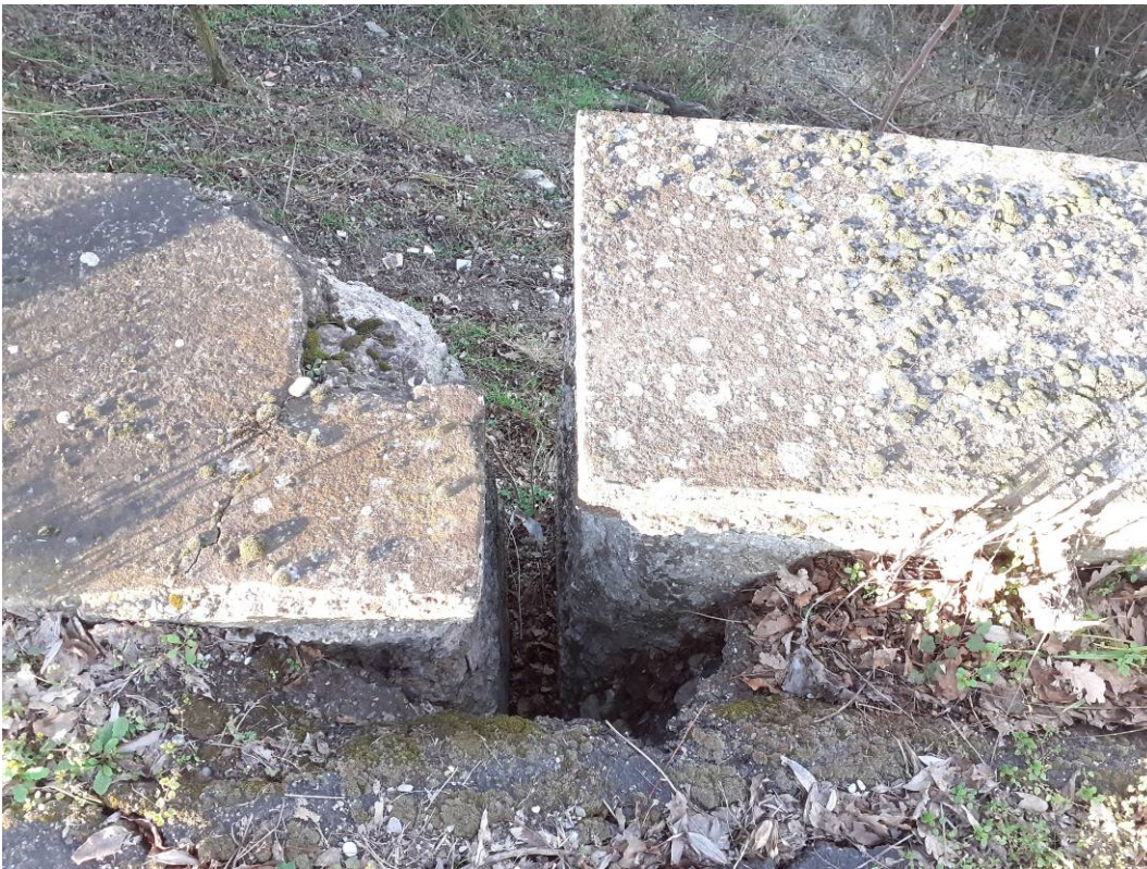
Foto 13 - Vista del distacco tra le porzioni di cordolo
