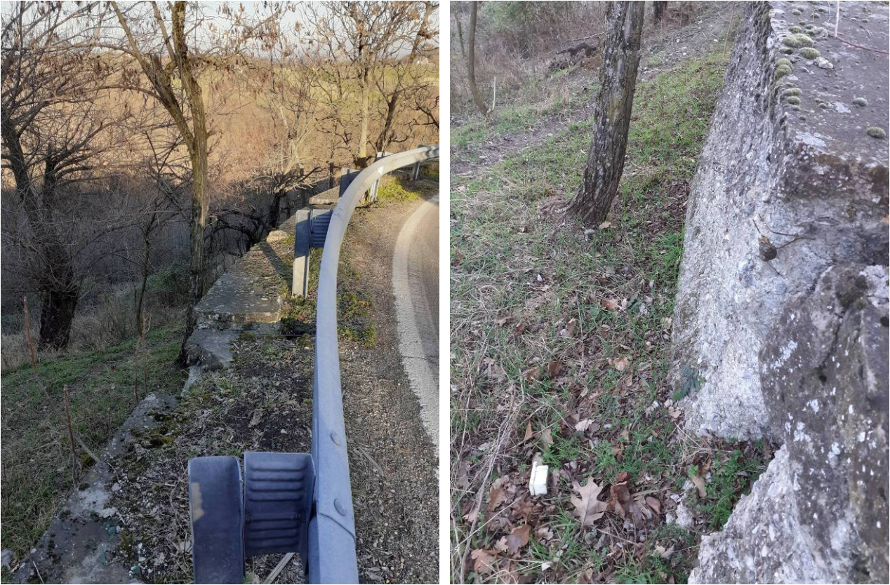
Foto 1 e Foto 2 – Vista dal cordolo e del muro in dissesto
