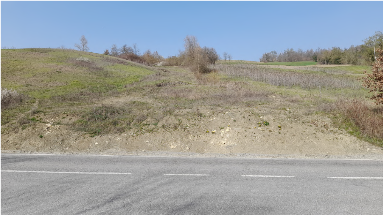
Foto 1 – Vista dalla strada del versante in dissesto.
