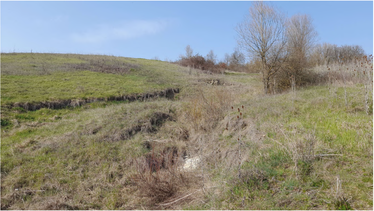
Foto 3 – Vista del versante in dissesto.
