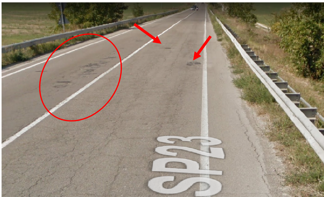
Foto 1 – Vista dei dissesti della pavimentazione presenti sul tratto oggetto di intervento dalla SP 23, con fessurazioni a blocchi e a ragnatela e con distacco di strati superficiale di conglomerato bituminoso.
