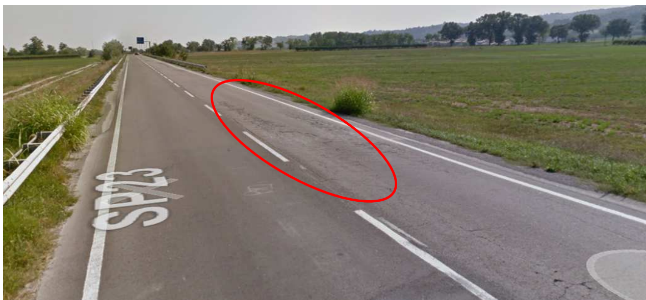
Foto 2 - Vista dei cedimenti della pavimentazione con la formazione di ormaie e depressioni nel tratto oggetto di intervento dalla SP 23.
