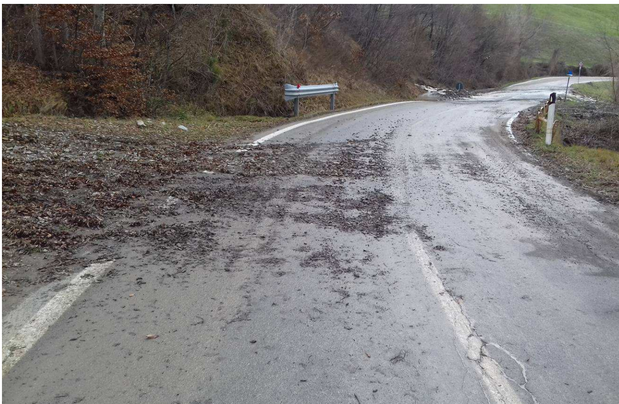
Foto 1 – Vista dell'esondazione a causa delle precipitazioni intense del dicembre 2017, con trasporto di terreno e detriti sulla sede stradale.
