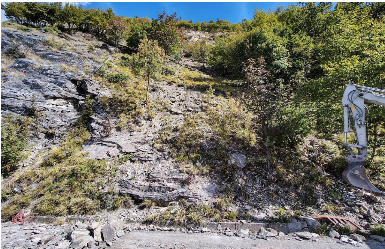
Foto 3 – Vista del versante che sovrasta la sede stradale della SP 15, durante le fasi di disgaggio nel settore di pendio dove sono caduti i massi nel 2025.
