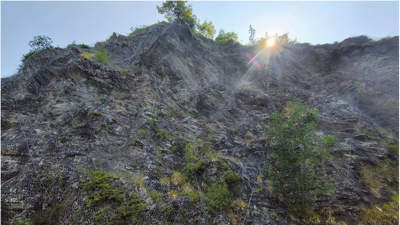
Foto 5 – Vista della parete rocciosa sovrastante la SP 15 dove è presente il rinforzo corticale esistente.
