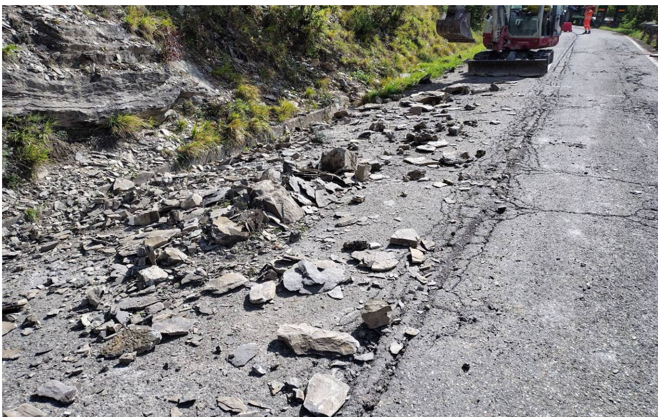
Foto 4 – Particolare delle dimensioni dei massi caduti sulla sede stradale durante le fasi di disgaggio.
