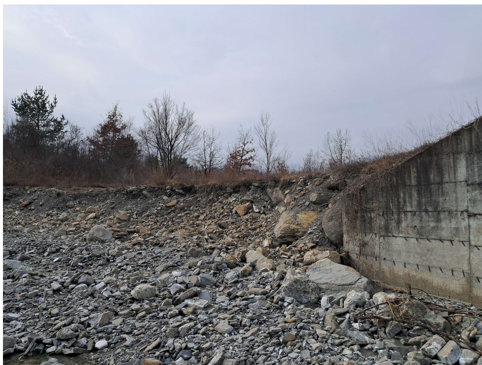
Figura 5 – erosione spondale tipo in prossimità dei muri andatori
