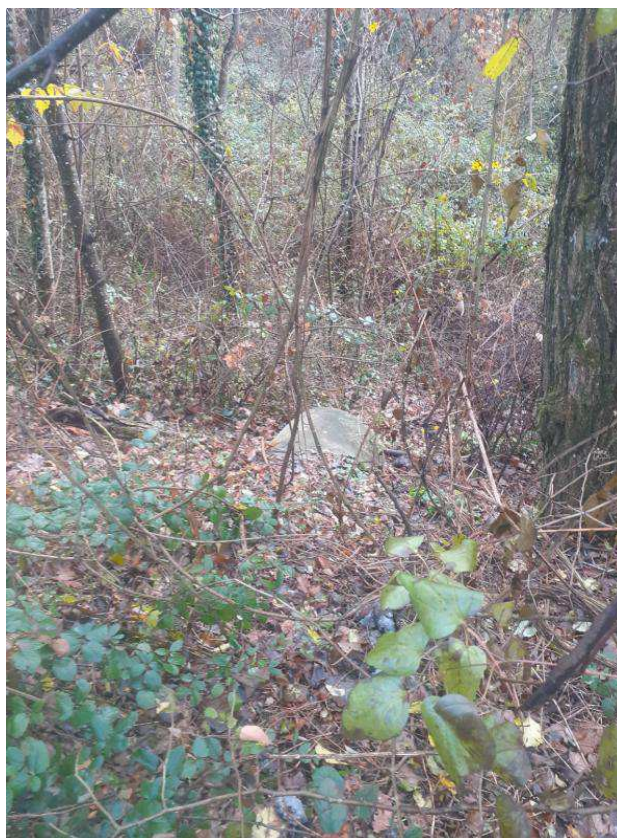
Foto 2 - Tubo di attraversamento del fognolo stradale
