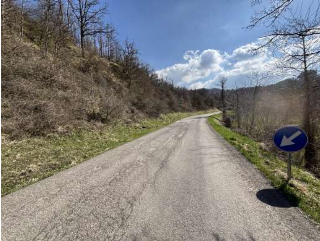
Foto 2 – Porzione dissestata a monte dell’abitato di Montemiscoso
