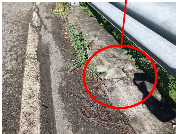
Lesione a compressione cordolo laterale spalla sx valle
