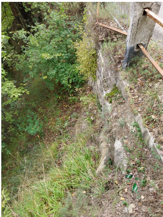
Foto 3 – vista del muro sottoscarpa con crolli
