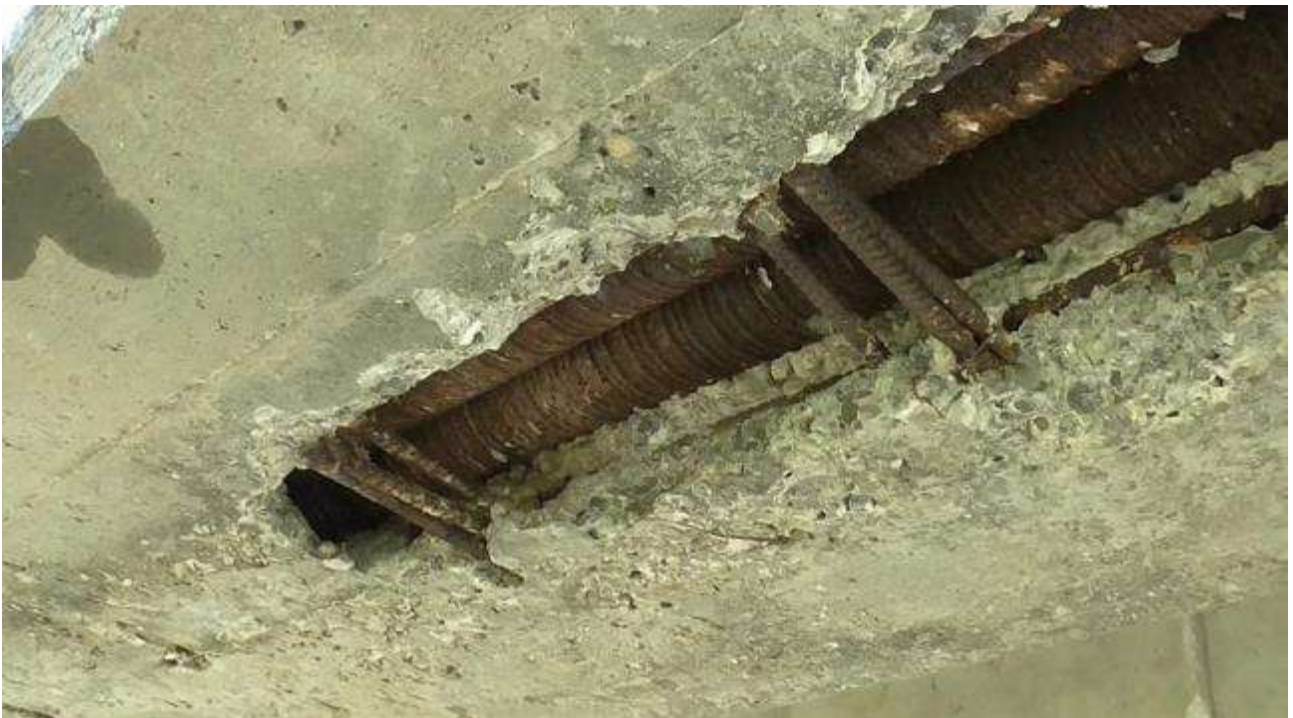
Figure 13 - Guaine ossidate dei cavi di precompressione
