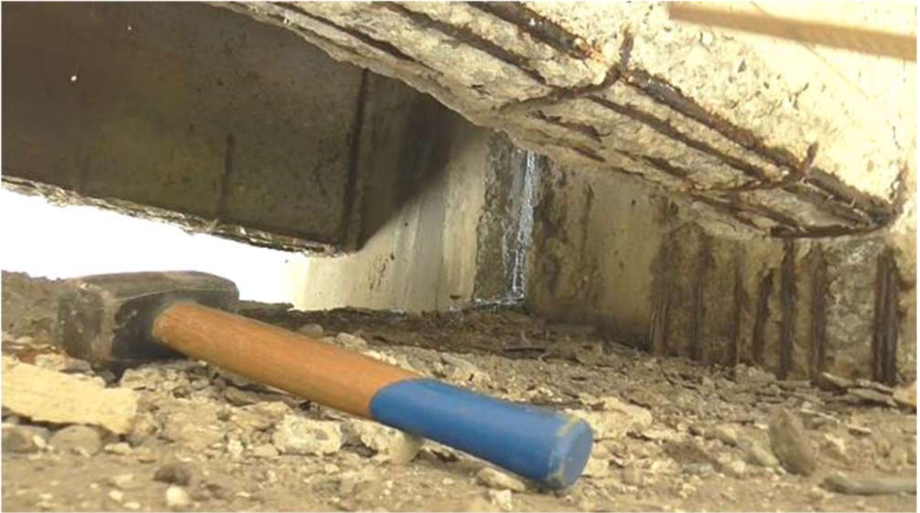
Figure 12 - Vista degrado trasverso
