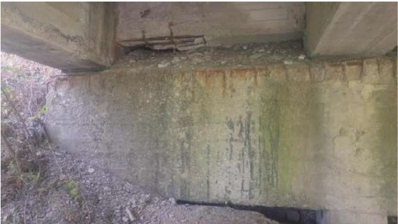
Figura 11 - Vista degrado spalle est e traverso terminale
