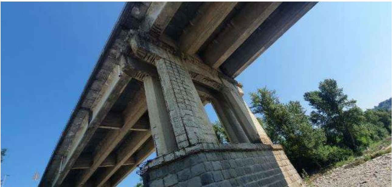
Figura 7 - Vista del degrado di basamento-pila e trave pulvino
