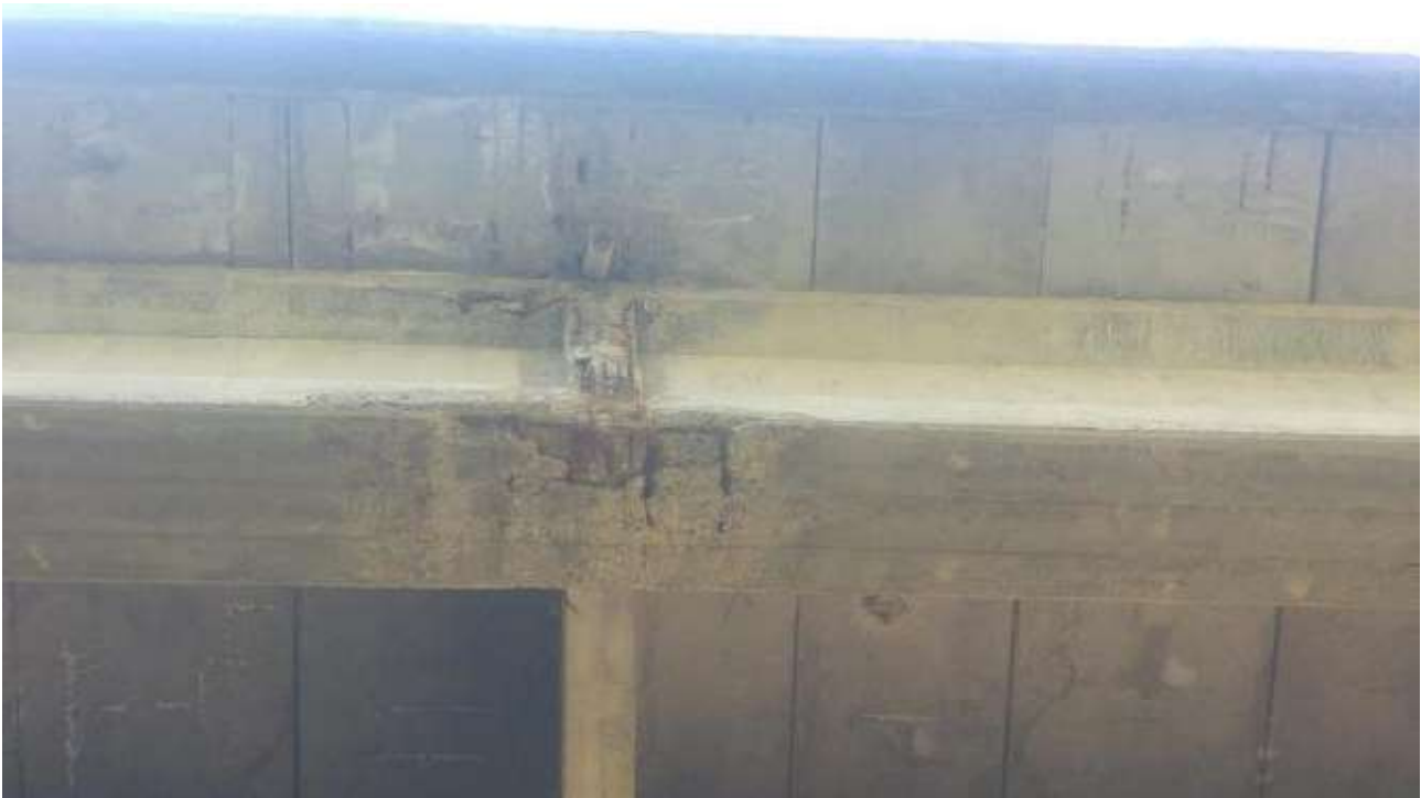
Figura 10 - Vista degrado di testata di traverso intermedio
