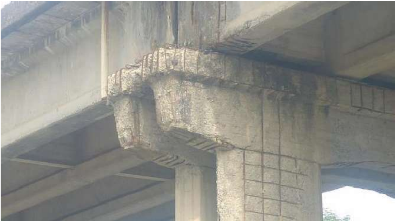
Figura 8 - Vista degrado trave pulvino
