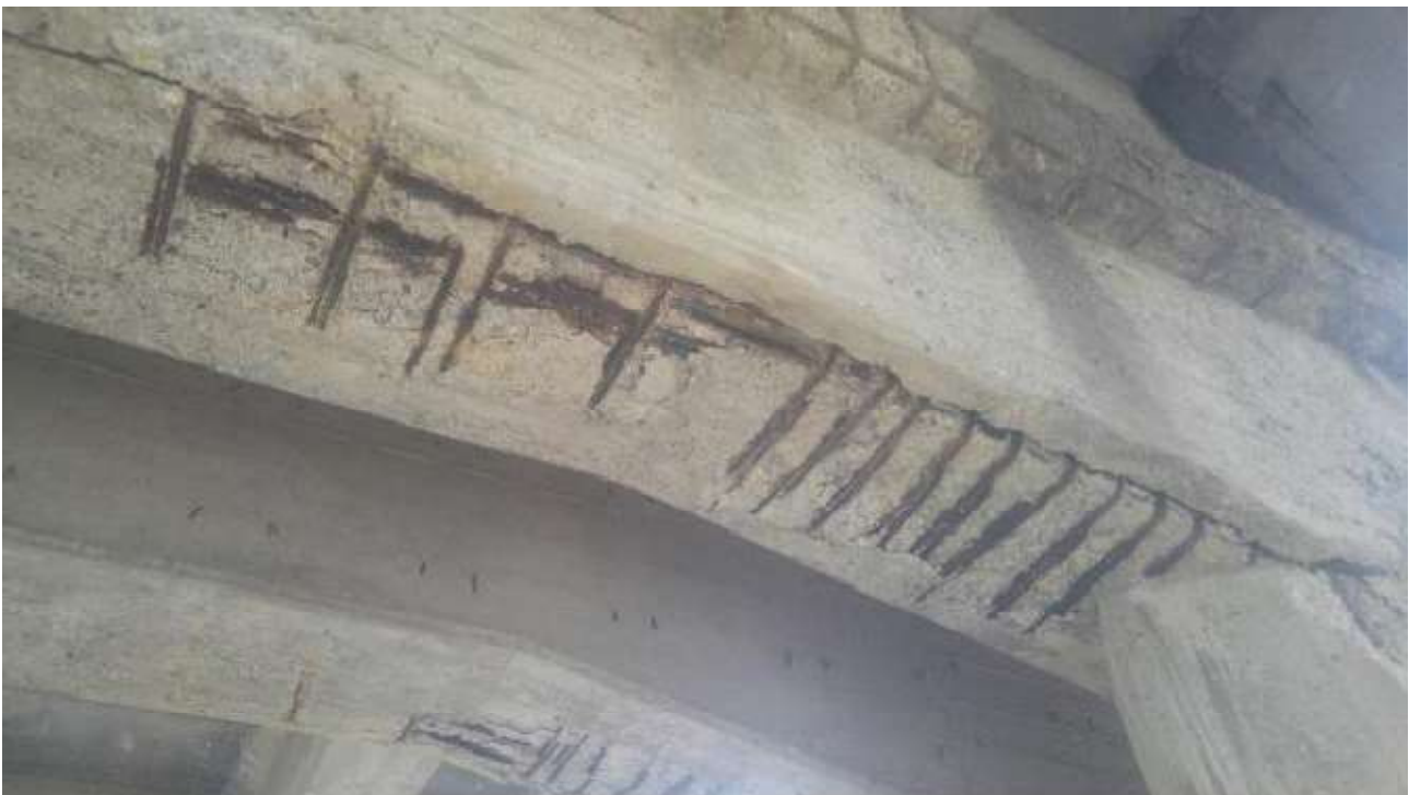
Figura 9 - Vista degrado intradosso trave pulvino
