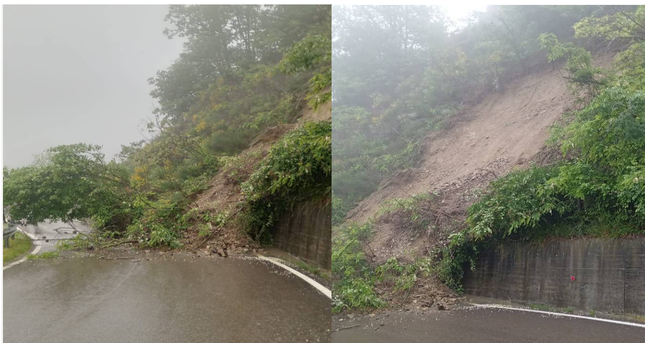
Foto 1 – Vista del punto in cui si è verificata la frana con ostruzione della carreggiata stradale
