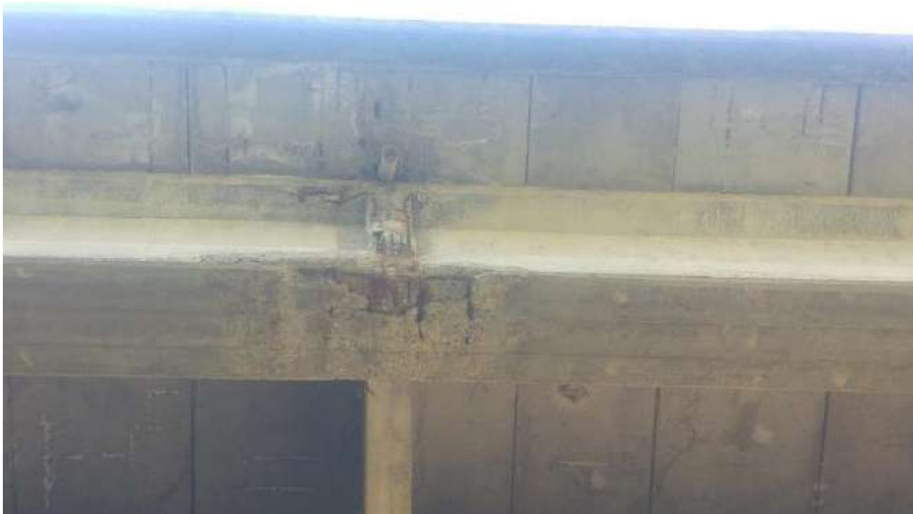
Figura 10 - Vista degrado di testata di traverso intermedio
