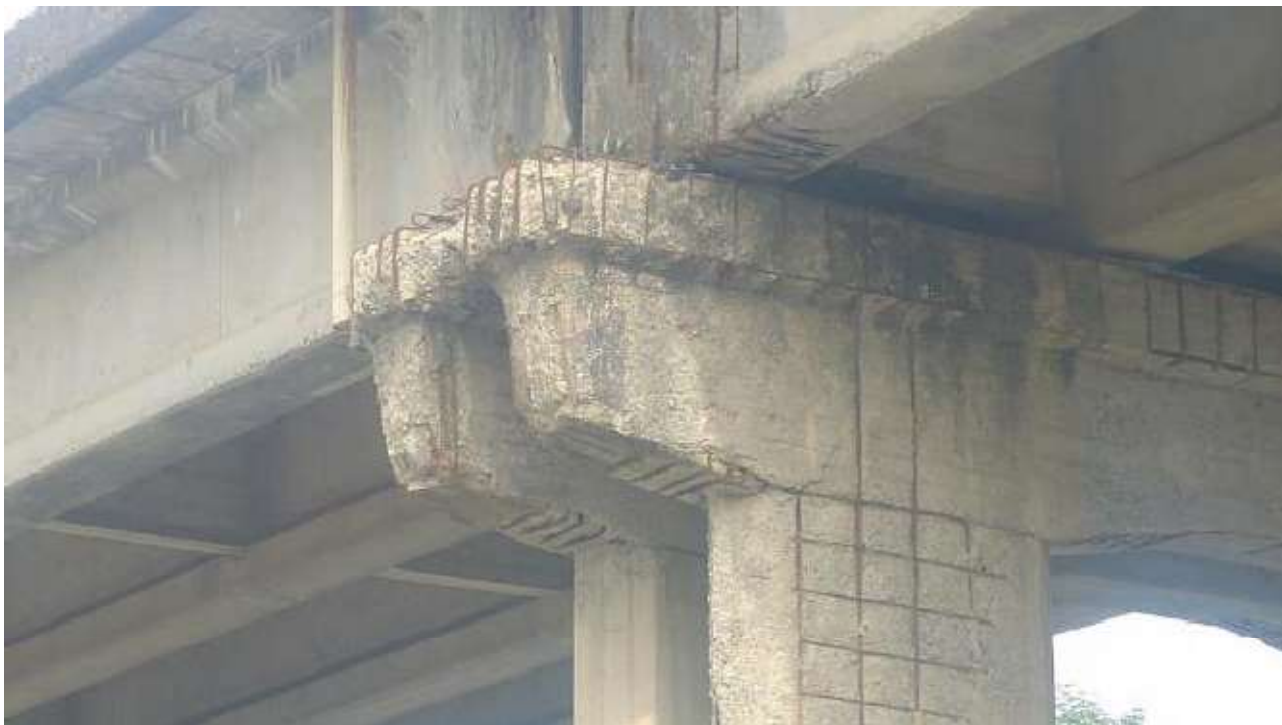
Figura 8 - Vista degrado trave pulvino
