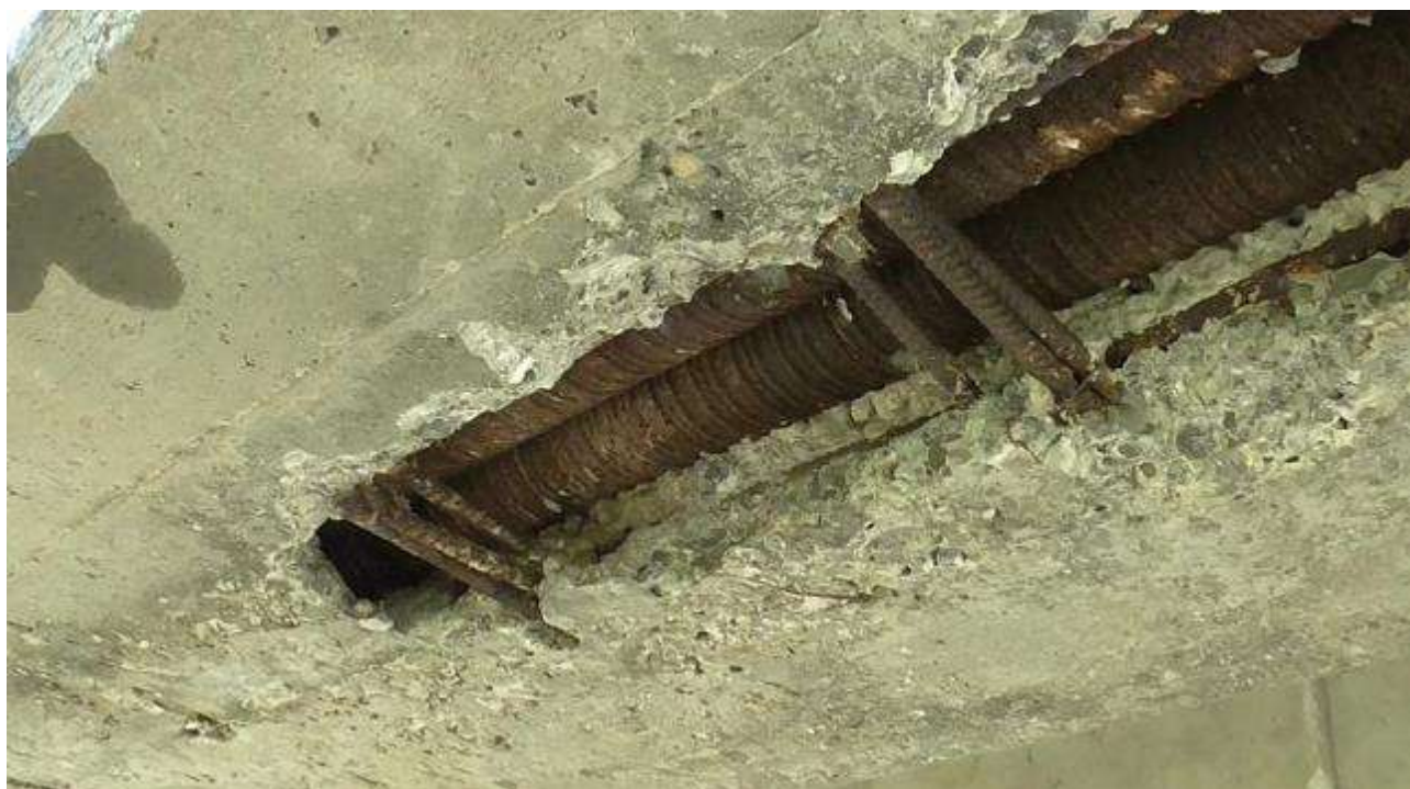
Figure 13 - Guaine ossidate dei cavi di precompressione
