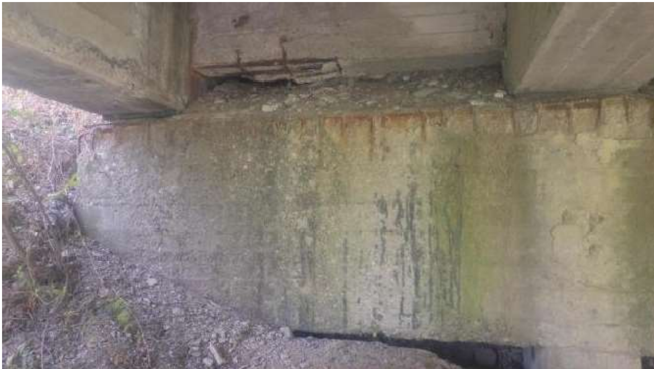
Figura 11 - Vista degrado spalle est e traverso terminale
