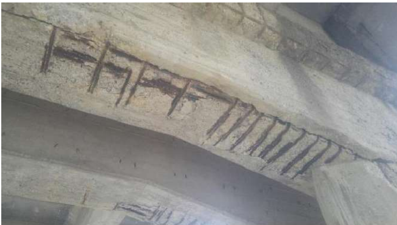
Figura 9 - Vista degrado intradosso trave pulvino
