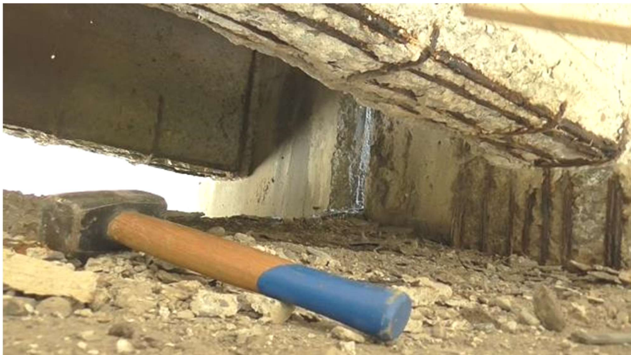
Figure 12 - Vista degrado trasverso
