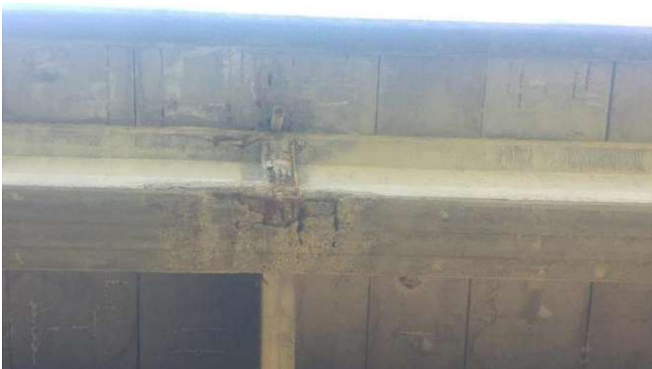
Figura 10 - Vista degrado di testata di traverso intermedio
