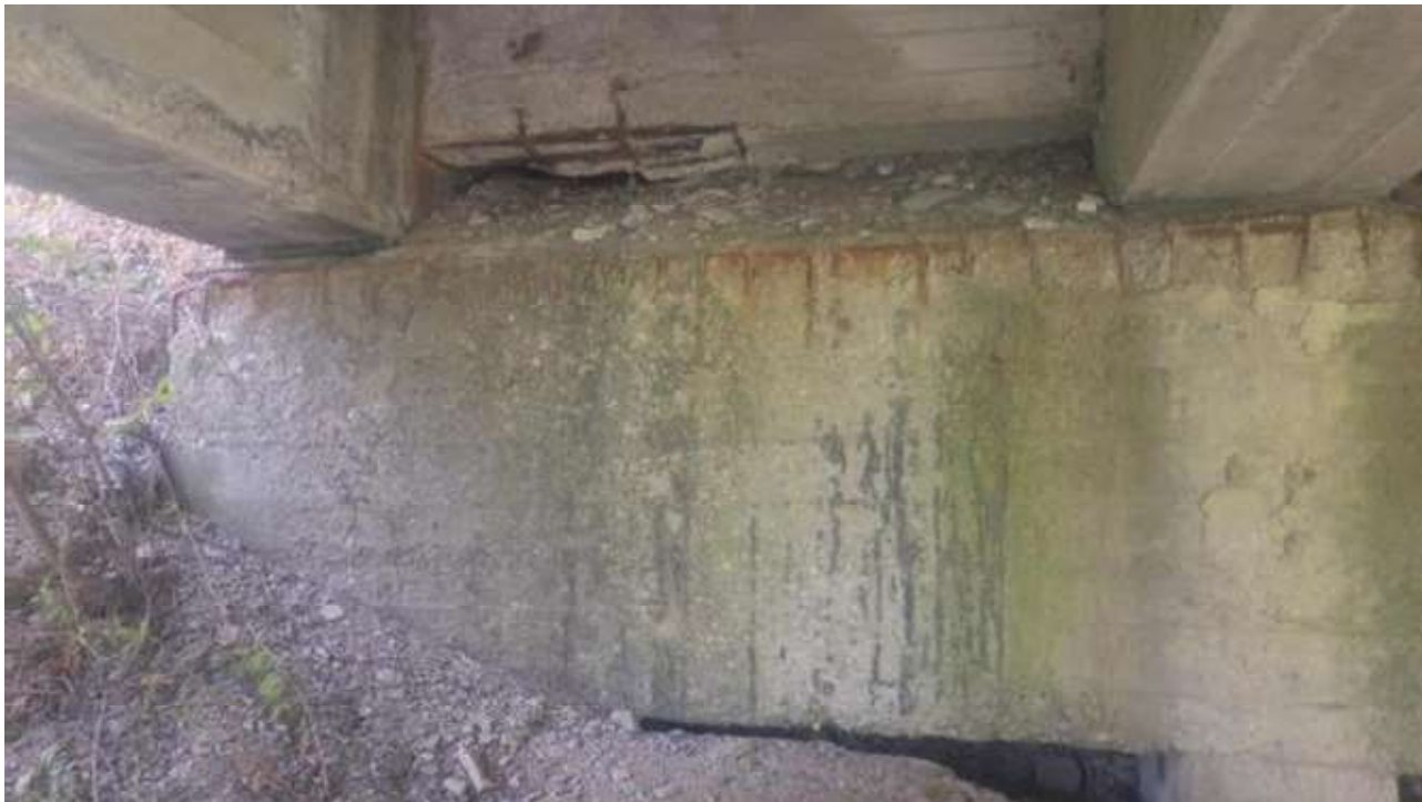
Figura 11 - Vista degrado spalle est e traverso terminale
