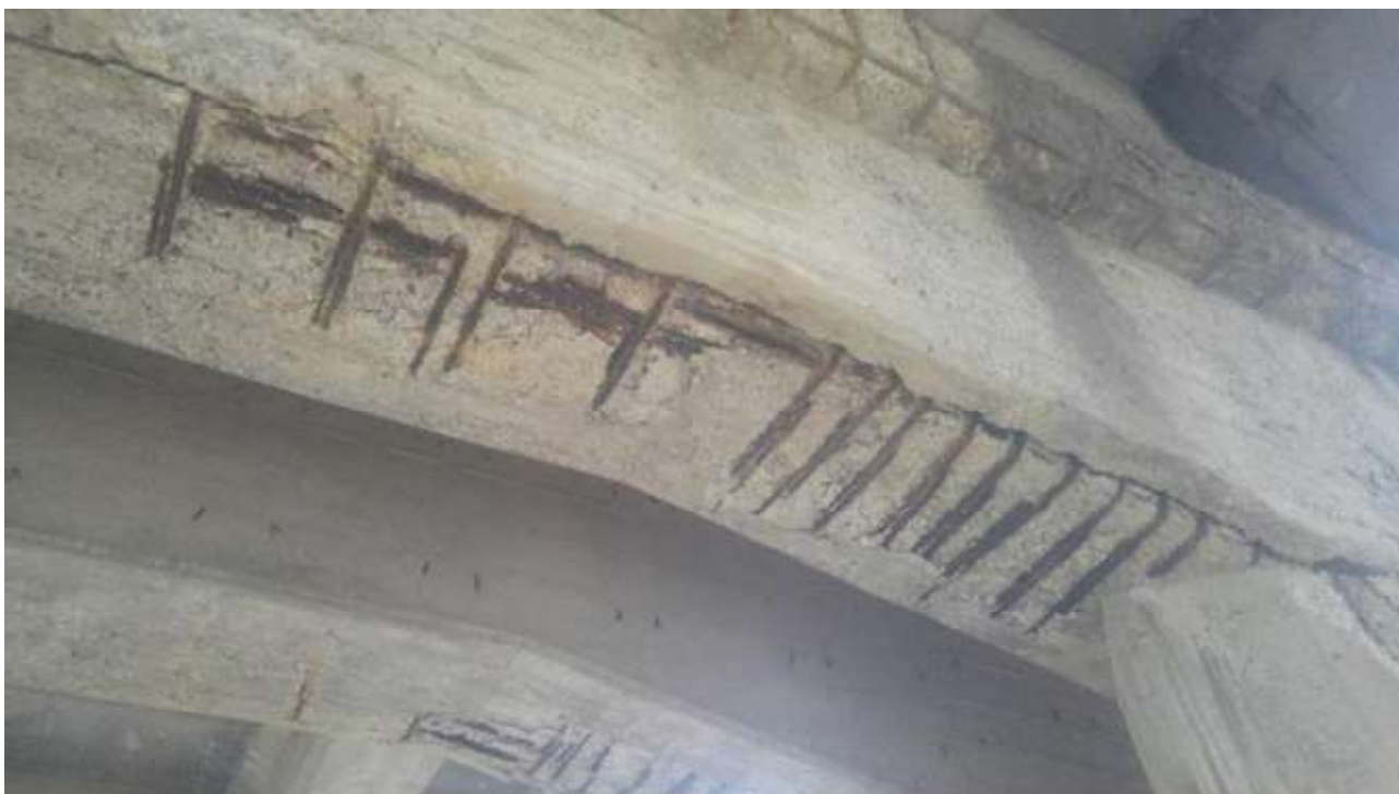
Figura 9 - Vista degrado intradosso trave pulvino
