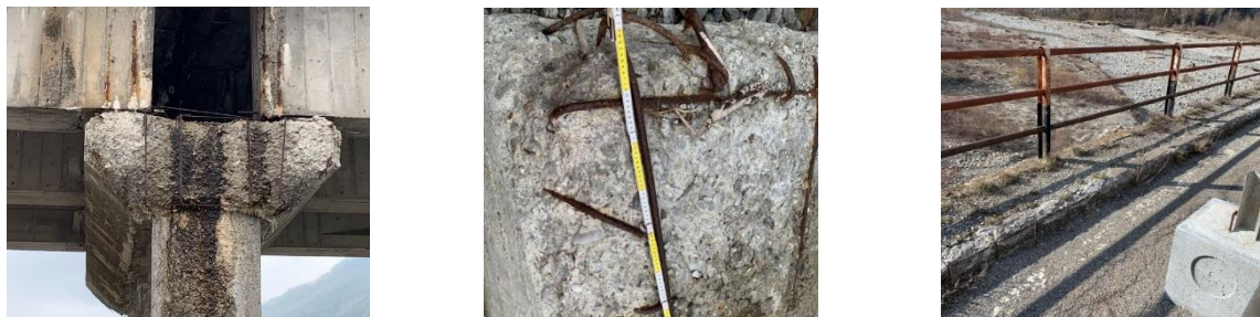
Copriferro ammalorati da ripristinare e parte del manto e della soletta esistente da demolire
