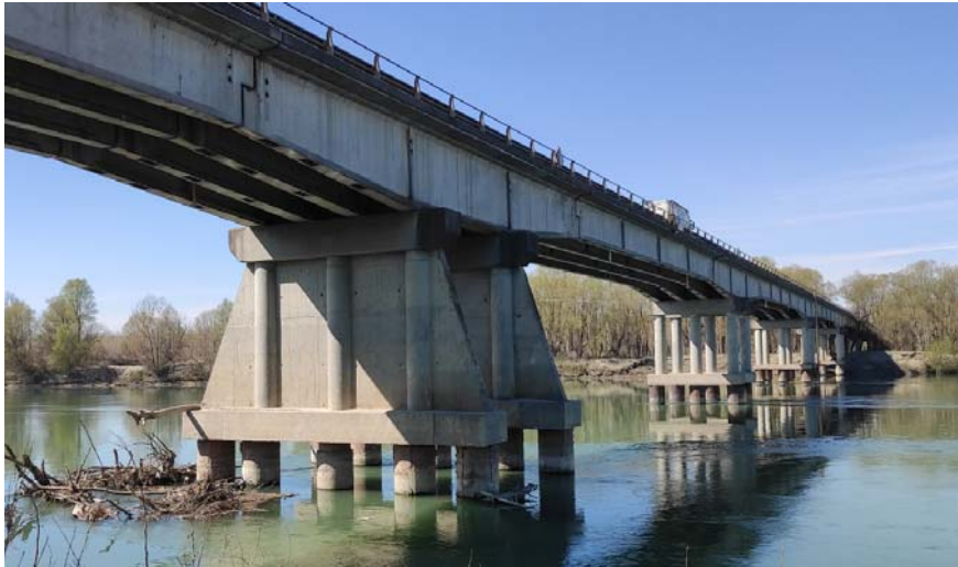
Figura 9.3: –foto delle pile in alveo. In primo piano la pila 9, a seguire la 8, 7 e 6
