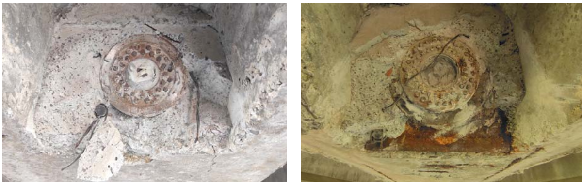
Figura 5.12: – teste di partenza dei cavi di precompressione, rilevate presso le travi su pila
