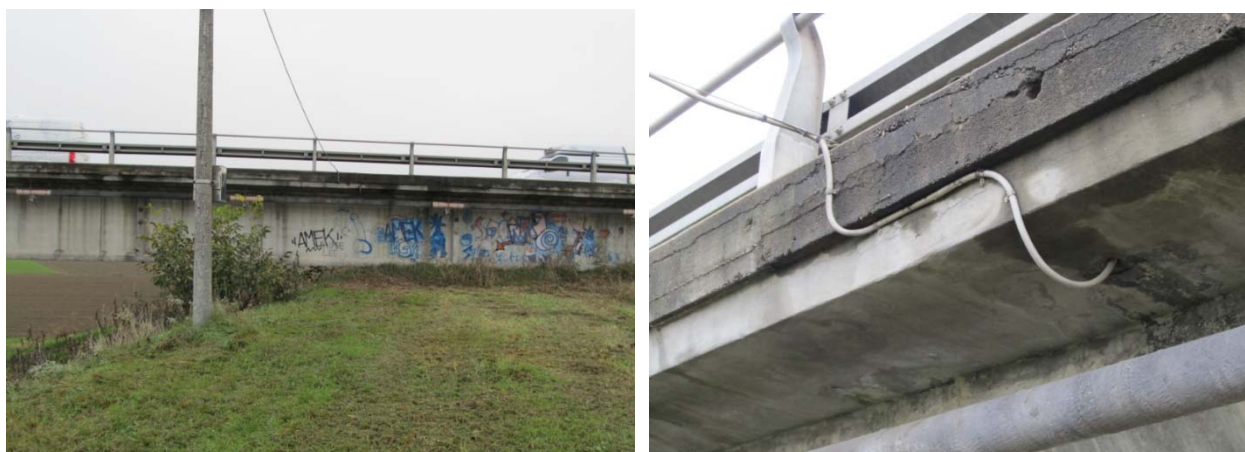
Figura 6.2: – palo con linea aerea BT (foto sx), cavo linea BT entrante nel cordolo lato di monte (foto dx)
