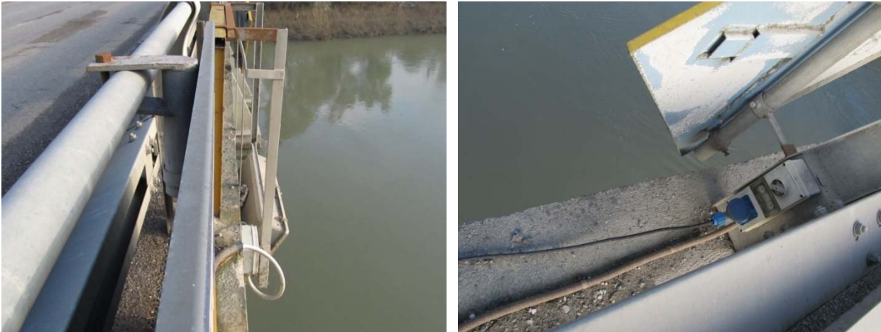
Figura 6.3: – impianti ed apparecchiature elettriche presenti sul ponte in prossimità del centro dell'alveo di magra
