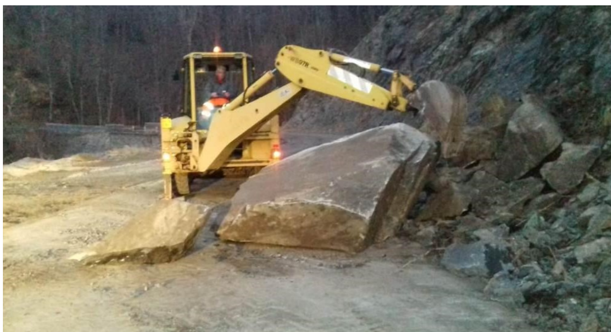
Foto 1 – Particolare dei massi che si sono staccati dalla scarpata di monte il 22/02/2021.
