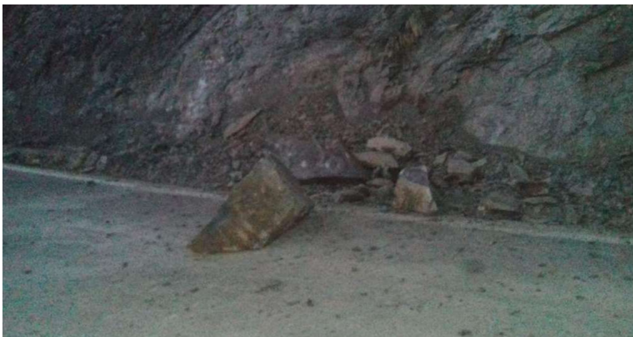
Foto 2 – Particolare dei massi crollati il 24/02/2021.
